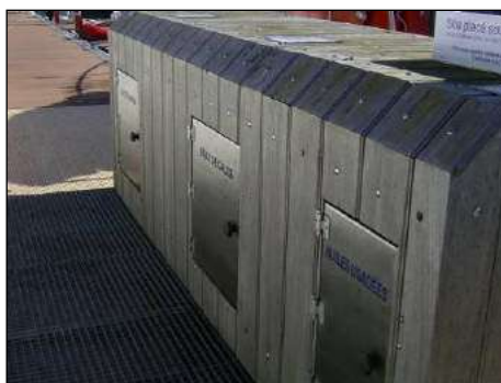
Bacs de vidanges des eaux usées et des huiles
